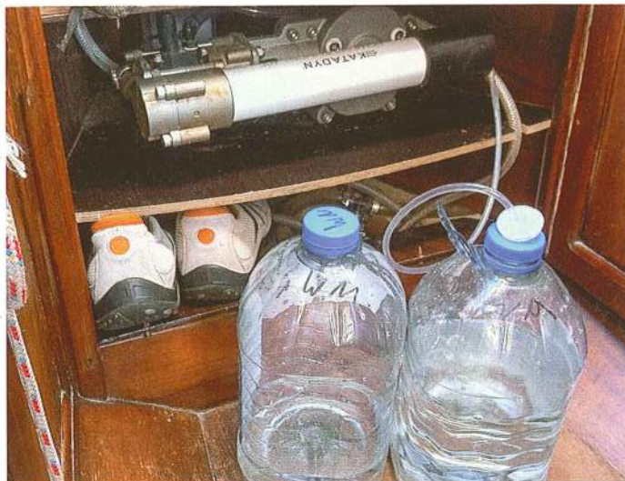
Umschaltventil: Wer seinem Tank nicht vertraut, kann mit einem Y-Ventil Trinkwasser in Flaschen abfüllen
