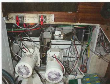
▲ Les deux moteurs électriques ont été à la hauteur des espérances placées en eux...
