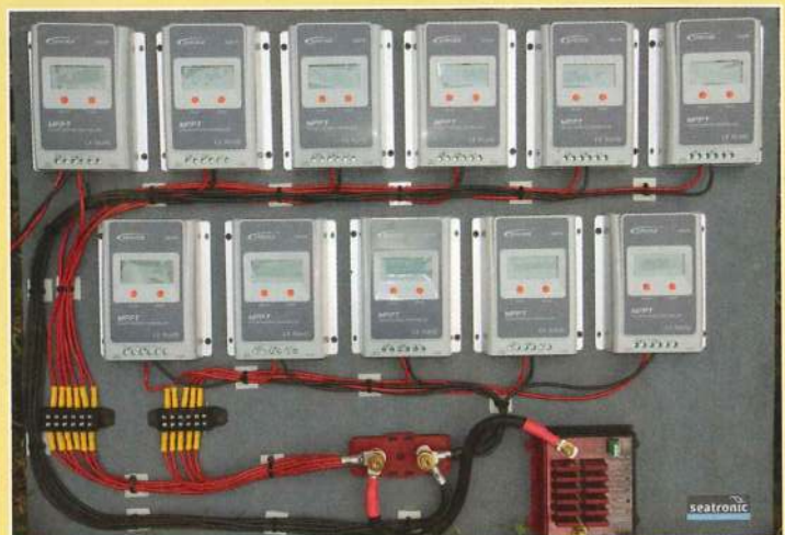
▲ Les dix panneaux étaient connectés à une batterie de régulateurs MPPT qui régulent la charge et permettent de récolter les données de façon optimale.
